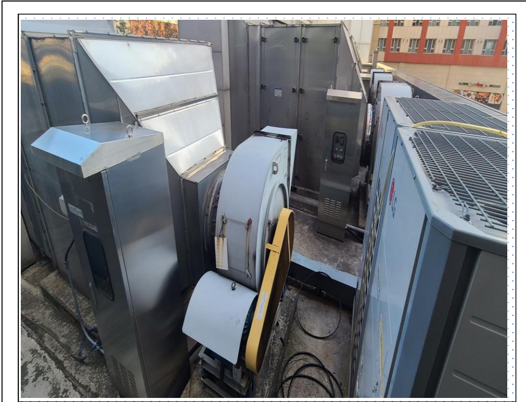
3층 단독 배기팬 사진
